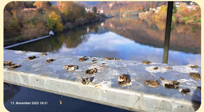
Taubenkot, Geländer der Eisenbahnbrücke
