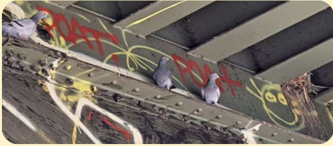
Tauben und Nest, Eisenbahnbrücke
